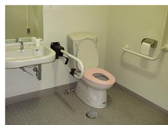
身障用トイレ完備
