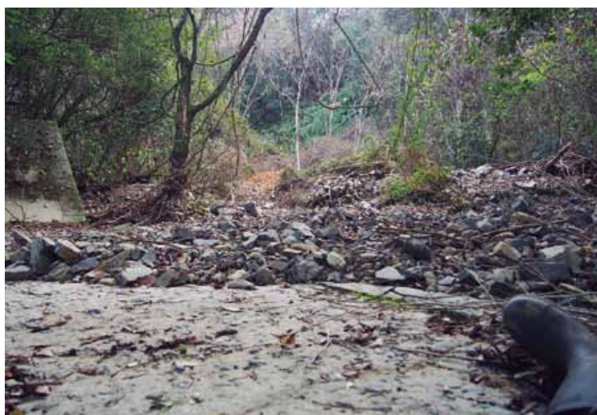
土砂で満杯となり砂防ダムの役割が厳しくなっている（笹場川上流）
