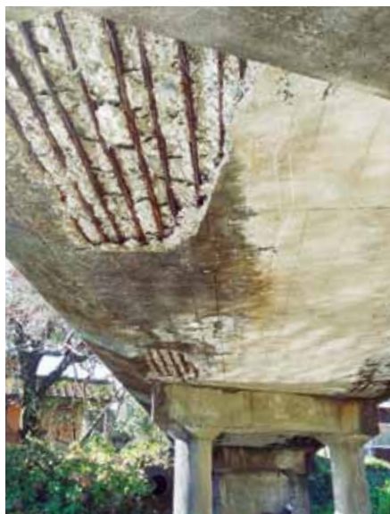
コンクリートが剥がれ落ち、鉄筋がむき出しになった大坂橋の下面（左）と橋脚（下）
