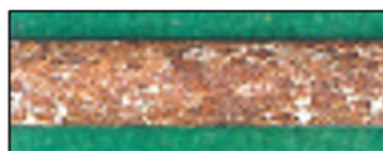
（腐食グレード：Ⅳ）
