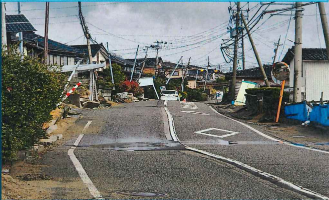
道路が歪んだり、電柱が傾いています
