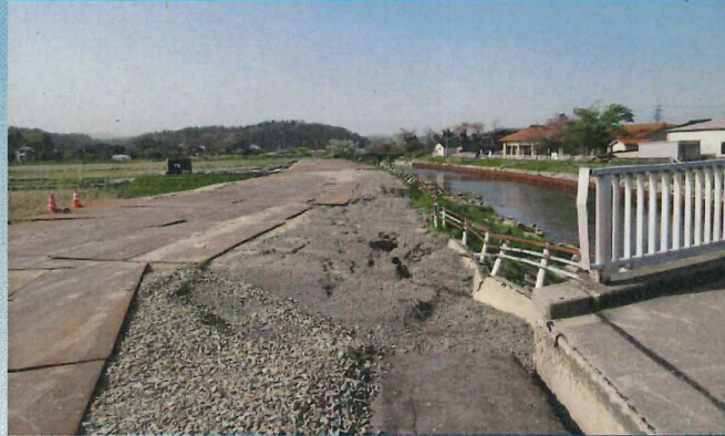
橋と道路の境に段差が生じています
