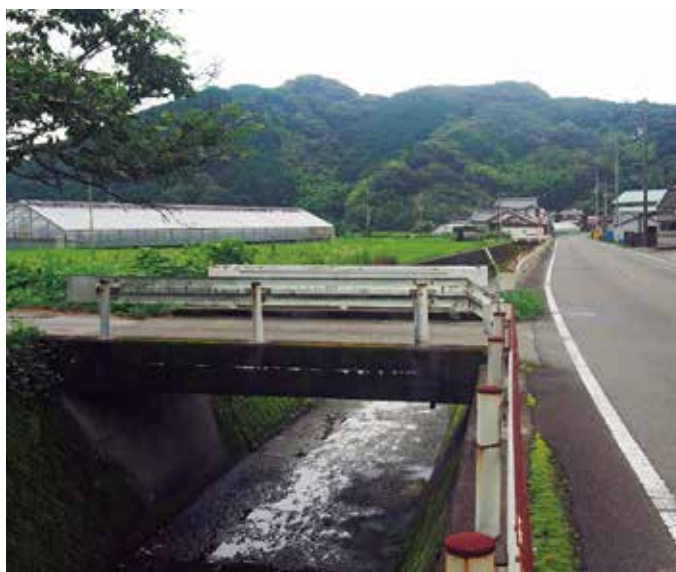
笹場川に架かる2本の橋、令和4年のような豪雨になると越流する危険がある
