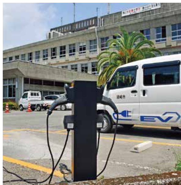
須崎市役所にある公設のEV充電器
