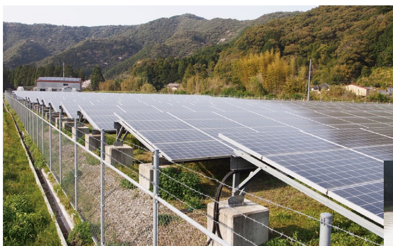
大北地区(久礼)に設置されているソーラーパネル
